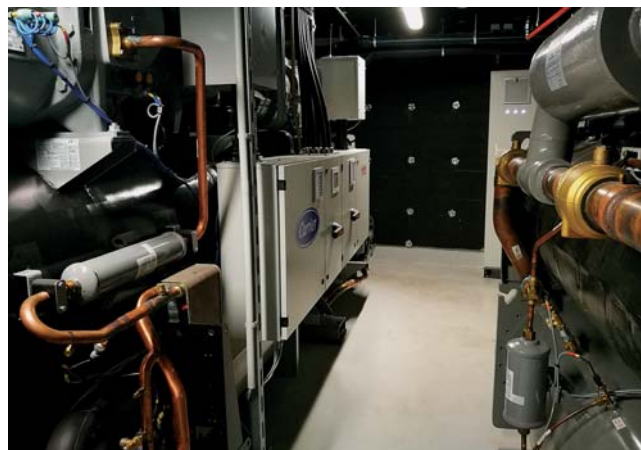
2. kép. Telekom gépház
